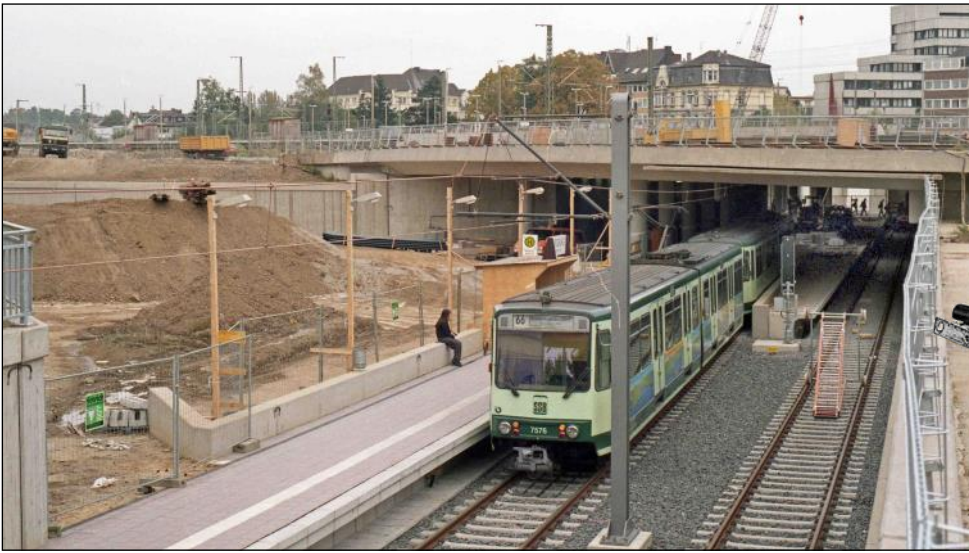
Knapp zwei Wochen zuvor war der neue Stadtbahn-Endpunkt Siegburg Bahnhof unter dem künftigen ICE-Bahnhof eröffnet worden (Foto vom 28. Oktober 2000). Zunächst fuhren die Züge der Linie 66 nur nach Gleis 2 ein, ab Juli 2001 konnte auch das hier noch gesperrte Gleis 1 in Betrieb genommen werden. ■ Foto: Volkhard Stern
